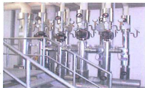
Die neue Verteilung zur Optimierung der Energieflüsse
