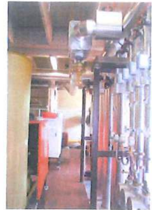
Die neue Verteilung zur Optimierung der Energieflüsse
