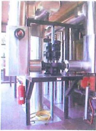
Einsatz von differenzdruck- geregelten Pumpen
