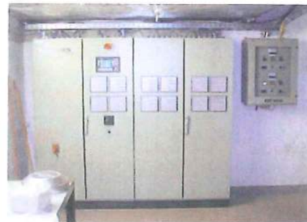
Neue und moderne außentemperaturabhängige Regelungstechnik für die Heizungs- und Lüftungsanlagen mit einer übergeordneten GLF- Zentrale
